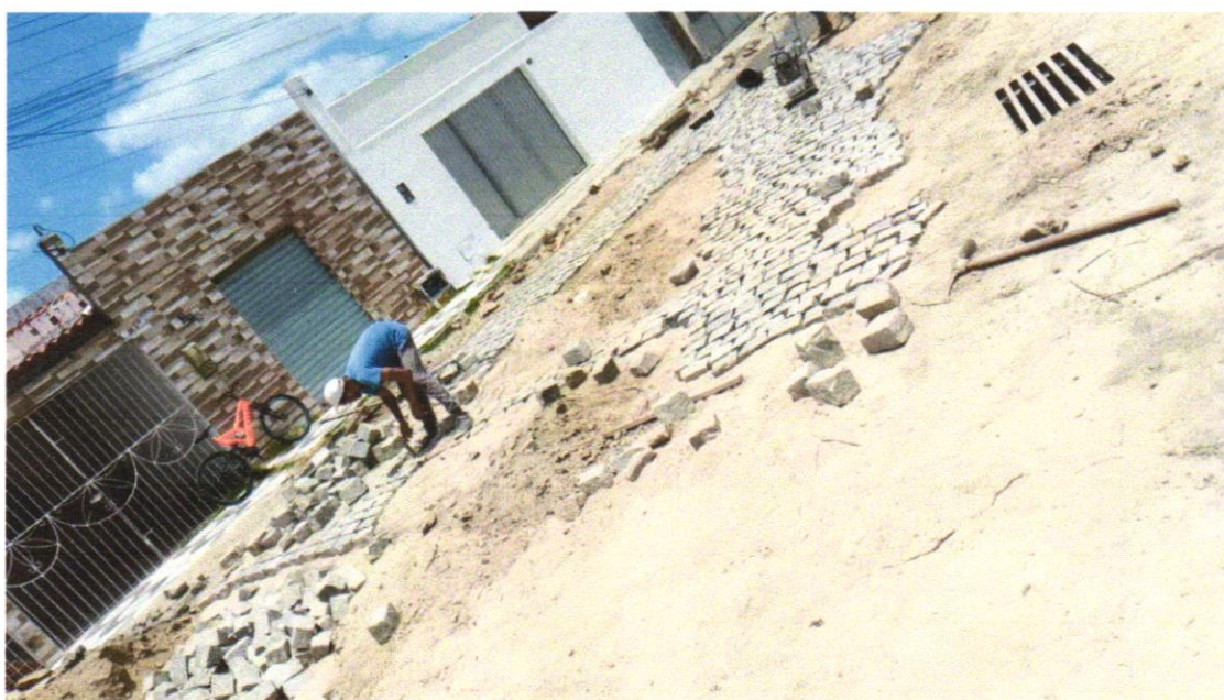
Foto 05 - ATERRO MANUAL COM SOLO ARGILLO-ARENOSO IMPORTADO E COMPACTAÇÃO MECANIZADA EM CAMADAS DE 0,20 M NO MÁXIMO
